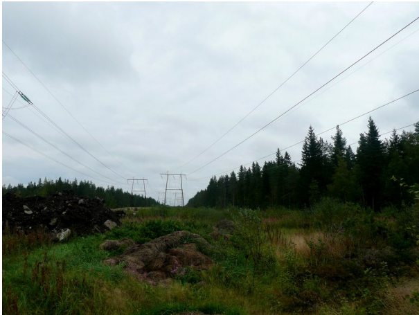
Kuva 17. Liittymiskohta Merijärven sähköaseman pohjoispuolella kuvattu pohjoiseen.
