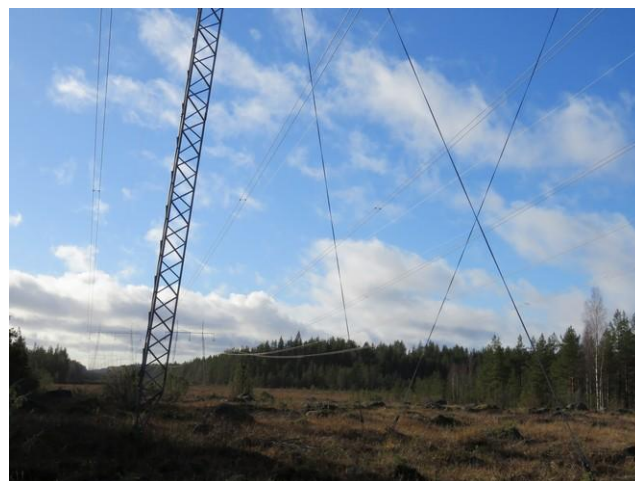
Kuva 22. Voimalinja Hautanevan luoteispuolella, kuvattu l Lounaaseen.
