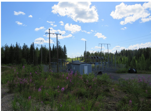
11. Sähköasema Vastasahon luoteispuolella.
