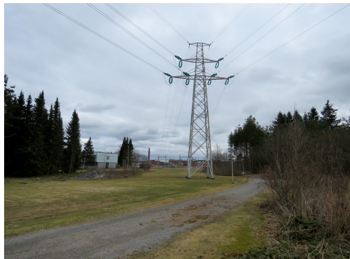
1. Keikyän muuntoasema itään.
