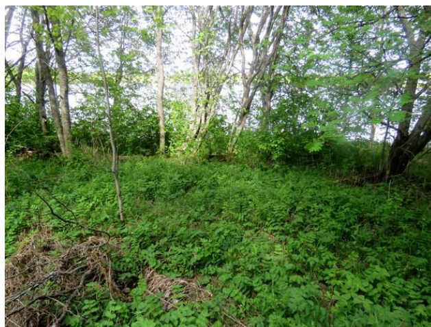
Kuva 8. Umpeen kasvanut varastonrakennuksen perustus Maa-Fantissa.
