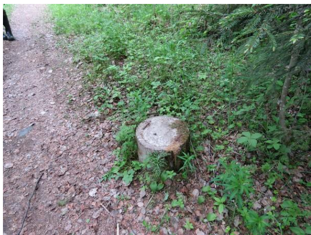
Hyppyrিতornin betonituki (yht. 3 kpl).
