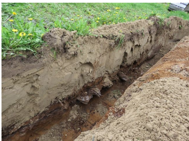
13. Muovijätettä sivuhaaran pohjalla.
