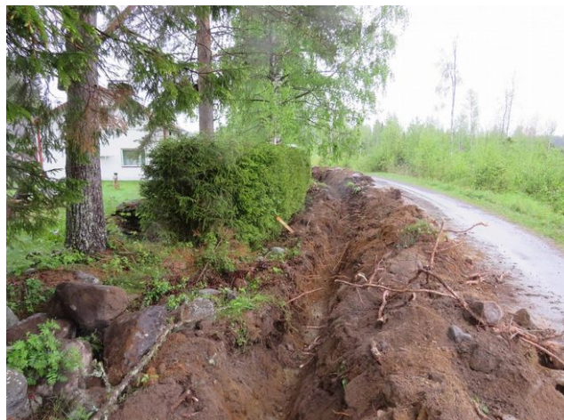
Kaapeliojaa kaakkoon Kurun ja Välimaan tilojen tieristeyksestä.
